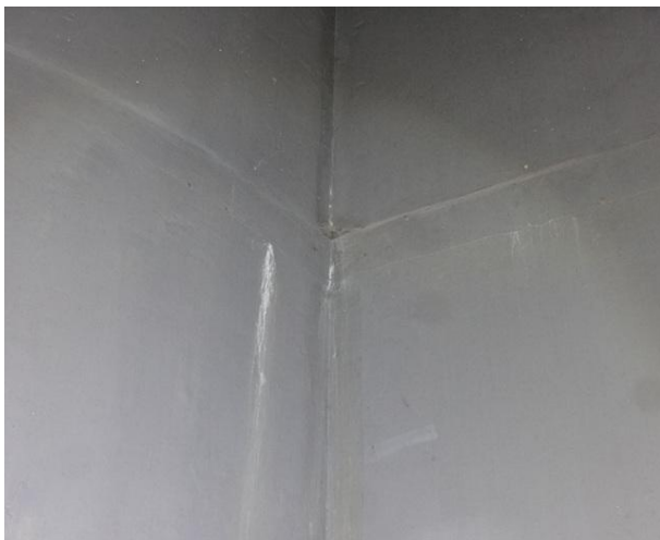
벽체 균열부 백태 (A=0.1m×1.0m)
