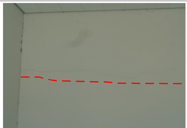
계단실 벽체 균열 (CW=0.3mm, L=5.0m)
