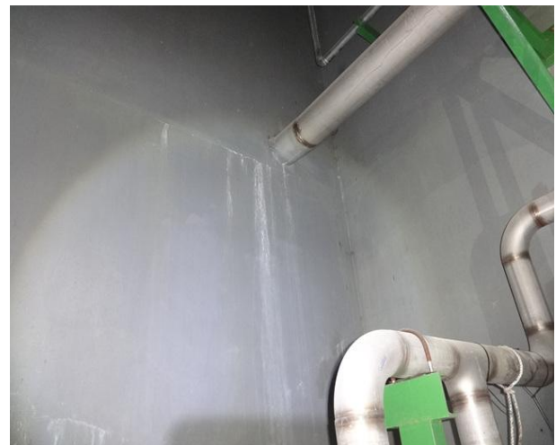
벽체 균열부 백태 (A=1.5m×0.3m)
