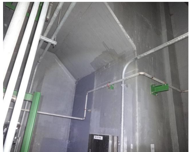
외부 벽체 누수흔적 -보수완료-
