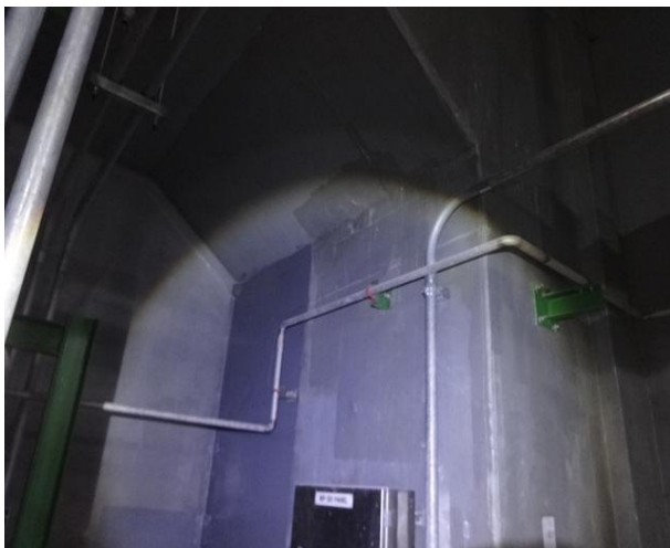
외부 벽체 누수흔적 -보수완료-
